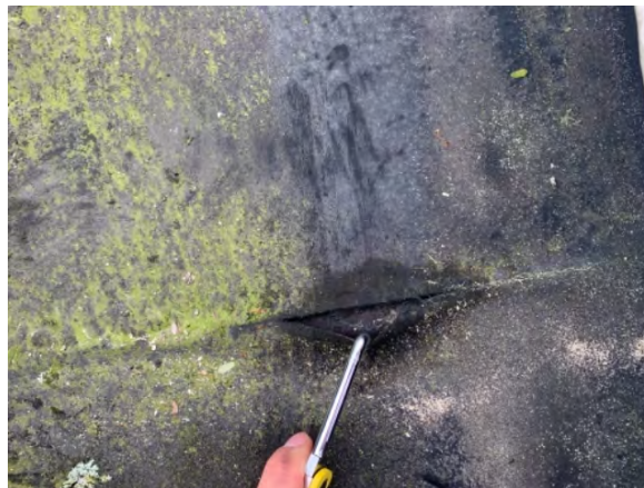
Tear in butynol gutter
