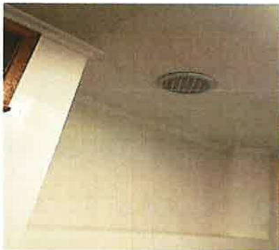
Bedroom ventilation fan
