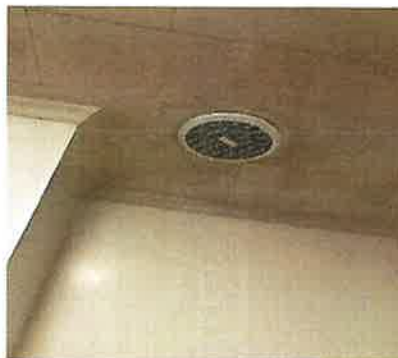
Bedroom ventilation fan
